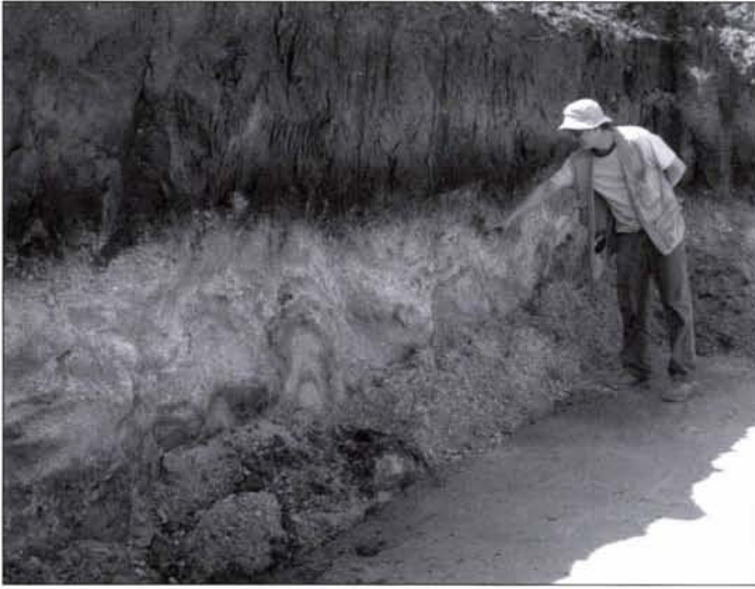
2. kép: Krioturbációs jégszak a pleisztocén „dolomit-murvában”. Felette éles eróziós határ által elválasztva a humuszos dolomit-törmelék, majd az üledék és talaj rétegekből álló „talaj-üledék rendszer” települ. (Kiscsillag utca 4.) Fig. 2: Involution by crioturbation in the „gravel of Pleistocene age”. The overlying humiferous dolomit-gravel is divided by an erosional surface, than a soil and sediment bearing complex covers (4 Kiscsillag Street)
