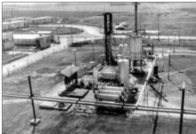
8. kép: Kardoskúti Gázüzemek
