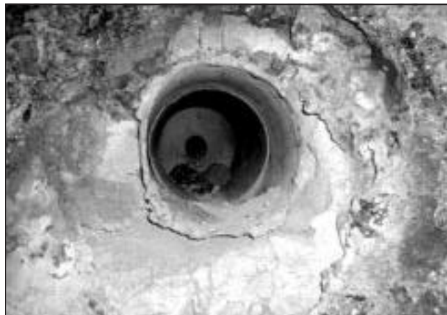
■ 5. ábra. A leszűkített fúvóka üzemelés után
