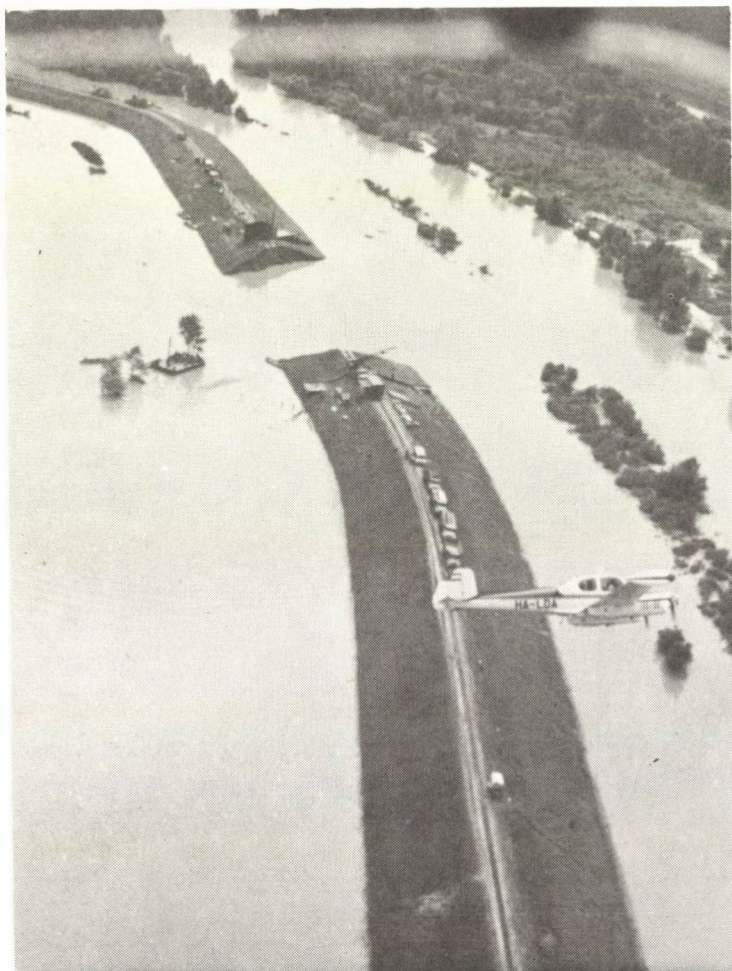
4. kép. Légifelvétel a Kettős-Körös jobbparti töltésszakadásáról (1980. július 30.). Fotó: Vízy Zs. Pict. 4. Aerial photograph showing the breach of levee on the right bank of the Double Körös Снимок 4. Брешь в правобережной дамбе р. Кеттеш-Көреш на аэроснимке
