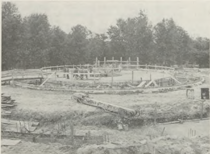
5. ábra. A TIT budapesti Planetáriumának lebetonozott nézőtere 1975. május 28-án, az alapkövetétel napján
