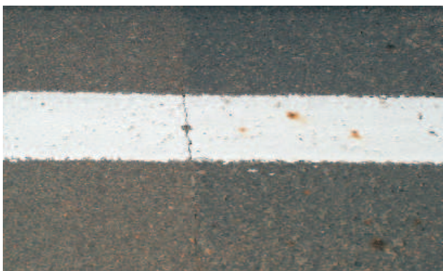
31. fénykép. Az M3-as autópálya 143,5 km-nél az aszfalt felszínének részlete a felfestett fehér terelővonalal. A fénykép közepén húzódik a két kőbányából származó zúzottkőből készült aszfalt határa. Ettől balra a rózsaszín árnyalatú „recski”, balra a sötétebb szürke „tállyai” aszfalt látható. Az utóbbi felszínén (kopófelületén) feltűnően gyakoribbak a vörösbarna rozsdafoltok
