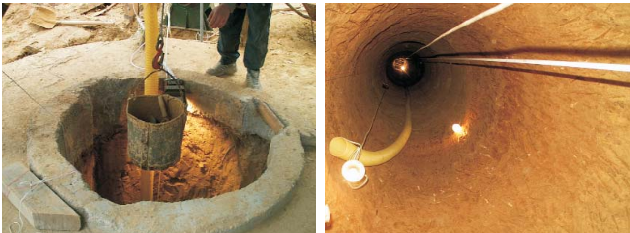
Figure 4. Dug Well K2 before ring casing 4. ábra. A K2 ásott kút gyűrűzés előtt
