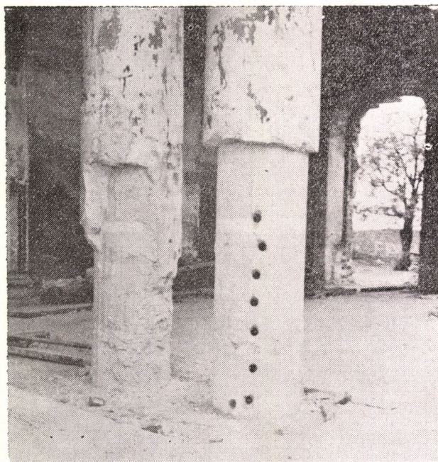
3. kép: Feltárás épületrobbantás előtt. Figyelemre méltó az igen vastag vakolat és a feltehetően igen sűrű vasalás
