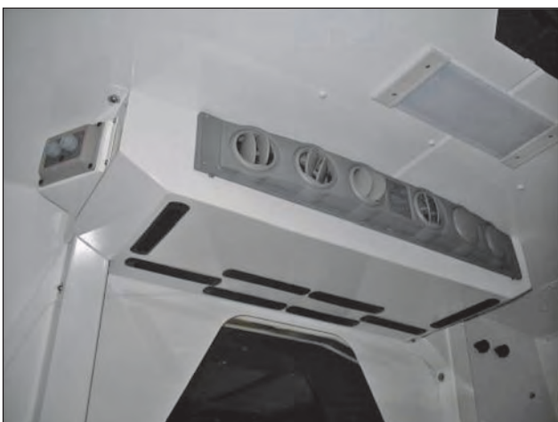
11. ábra. A sebesültszállító tér beépített klímaberendezése, illetve annak kezelőfelülete
