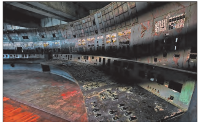
2. ábra. A 4. blokk kiégett vezérlője
