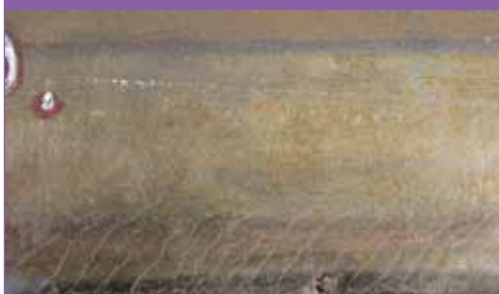
5. ábra: „S” alakú sínfej-hajszálrepedések
