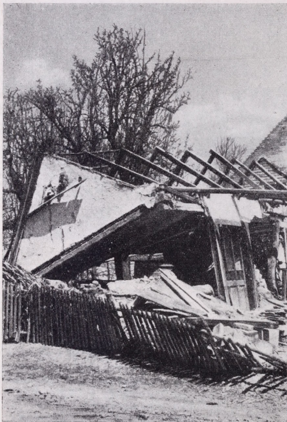
Az átázott falak összeomlottak a tető terhelése és a padláson tárolt gabona súlya alatt
