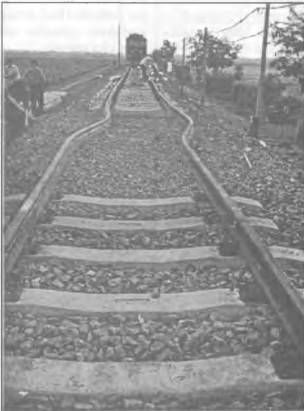
26. ábra Az egyenes közepén 13,5 m hosszban betonaljak nélküli vágány kivetődése
