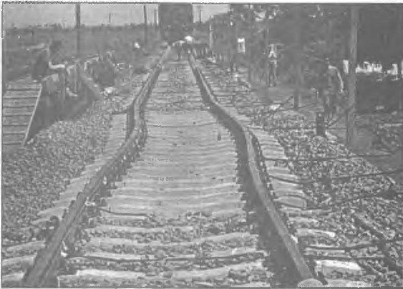
25. ábra Az egyenes közepén 13,5 m hosszban klágyazott betonaljas vágány kivetődése
