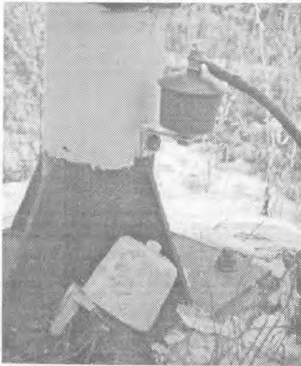
10. ábra A leszerelt, régi típusú (AZSD) és a felszerelt, új típusú (VKI) 500 V-os szikraköz fényképe
