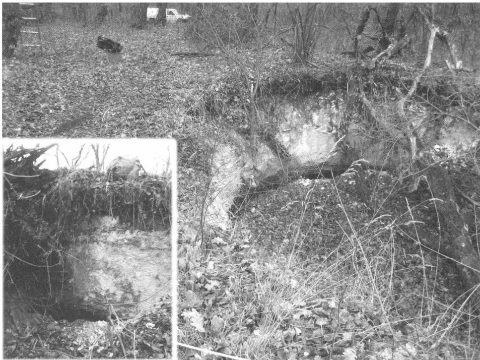
5. ábra A teszterület peremén található jellegzetes beszakadásos mélyedés, oldalfalában egy üreg részlegesen elzárt bejáratával
