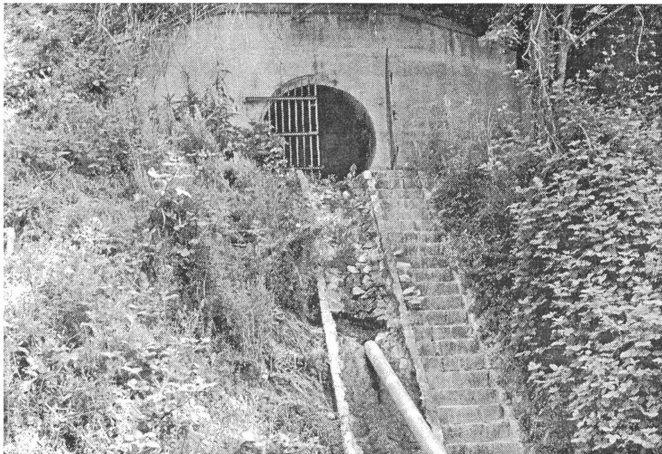
4. kép. Rekonstrukcióra szoruló vízelvezető alagút a Balatonakarattyai magaspart részűjében (Juhász Á. 1996)
